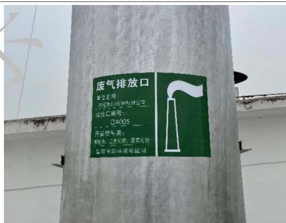
3#烧毛废气排气筒 (DA005)
