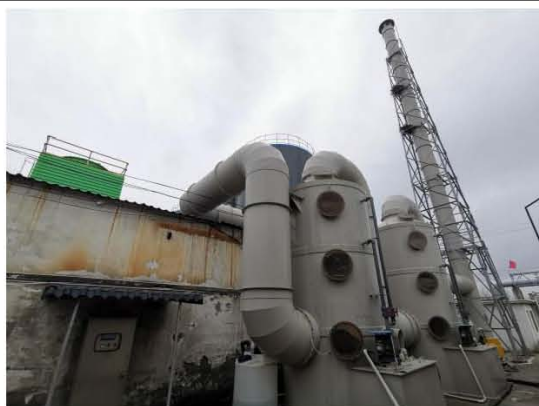
练漂废水处理站生物除臭设施
