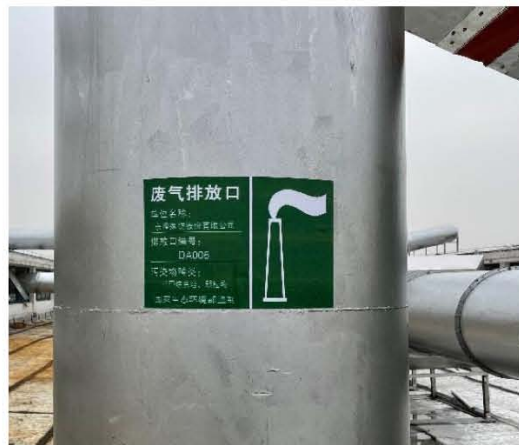
3#生产车间定型废气排气筒 (DA006)
