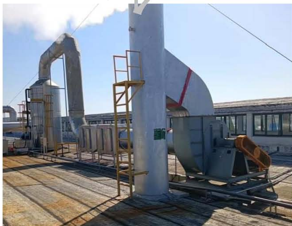
3#生产车间定型废气处理设施及排气筒
