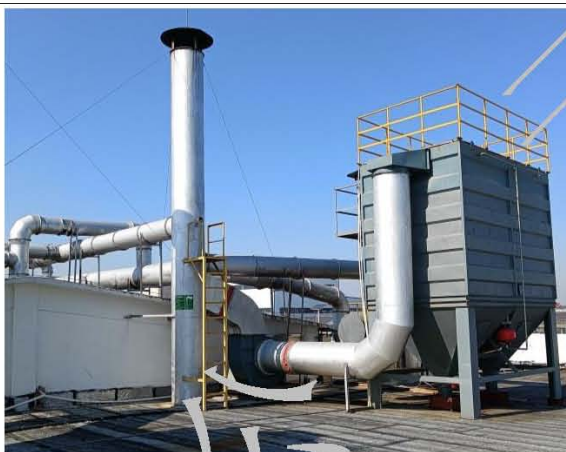
3#烧毛车间除尘设施及排气筒
