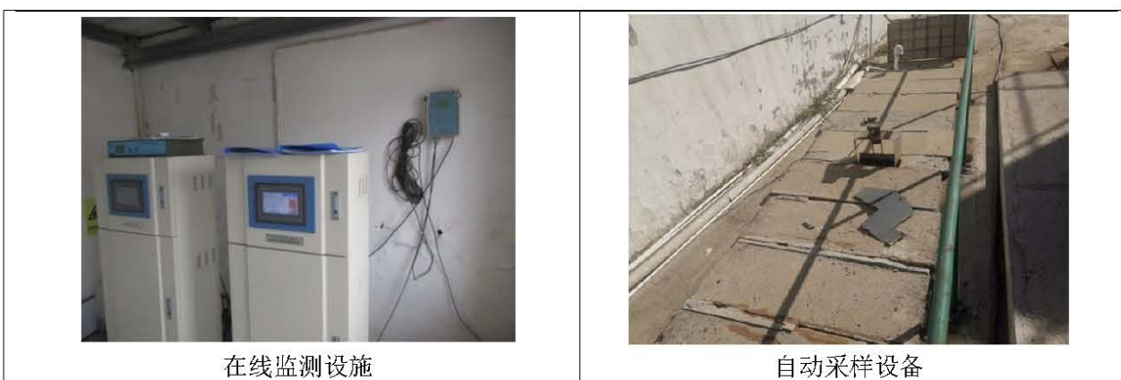
图 3-9 练漂废水处理站在线监测装置
