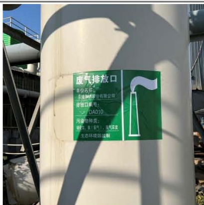
练漂废水处理站废气排放口（DA010）
