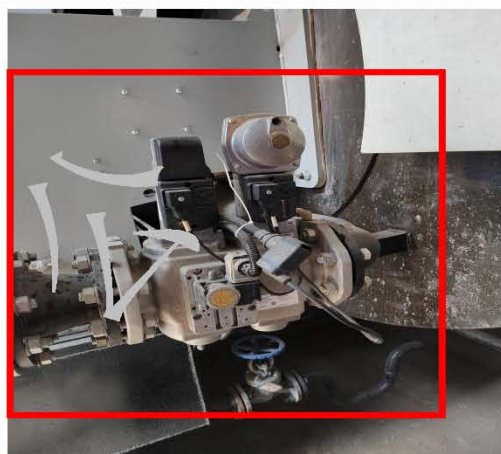
锅炉低氮燃烧器
