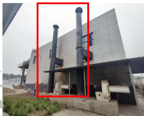
锅炉废气排气筒
