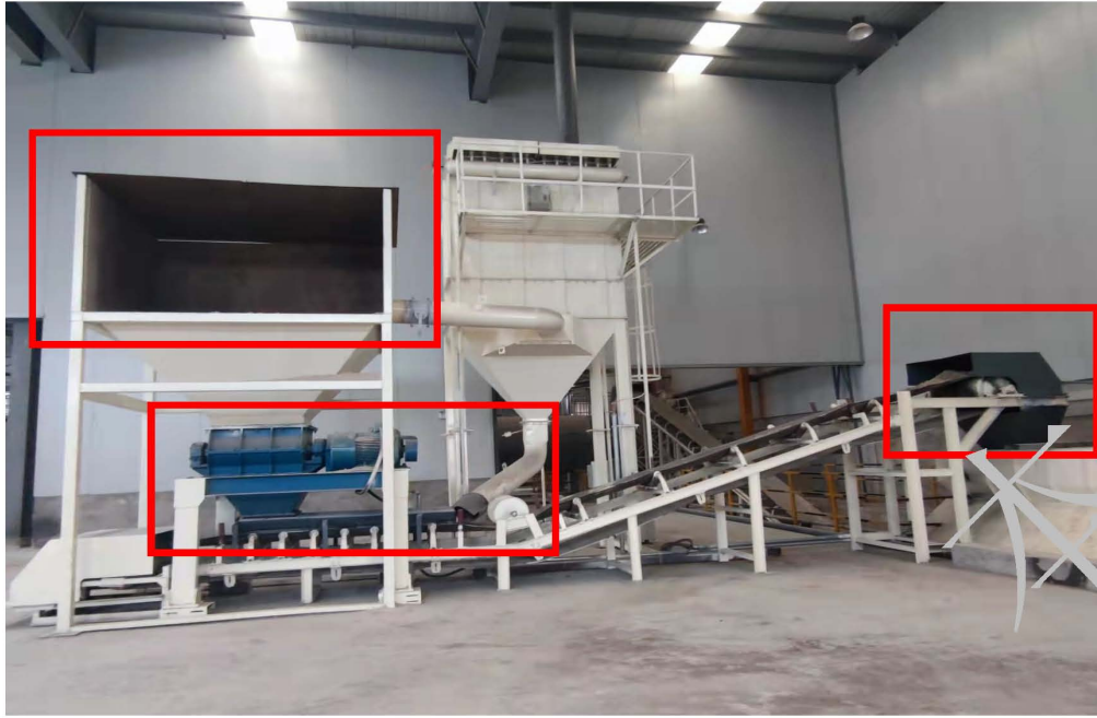
破碎工序废气治理措施
