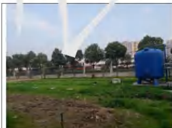
600m 3 /d 生活污水处理
